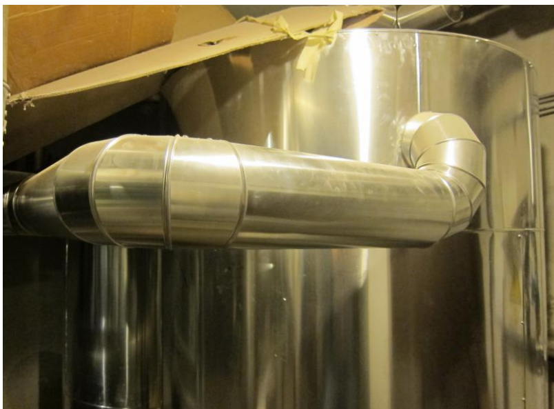
Slika 4: Grelniki za toplo sanitarno vodo
